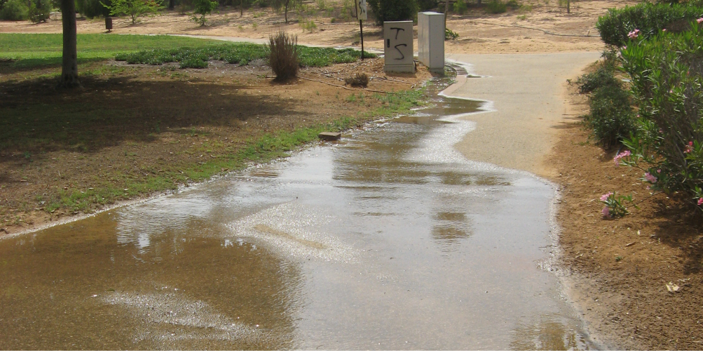
Bild 2 – Staunässe aufgrund inadäquater Planung und/oder Handhabung des Bewässerungssystems in einem Böschungsbereich. Foto: Avigail Heller
