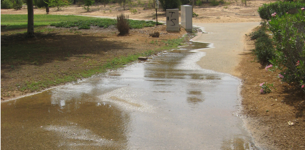
Εικόνα 2- Πλημμύρα νερού λόγω ανεπαρκούς σχεδιασμού ή /και λειτουργίας συστήματος άρδευσης σε μια επικλινή περιοχή. Φωτογραφία: A. Heller
